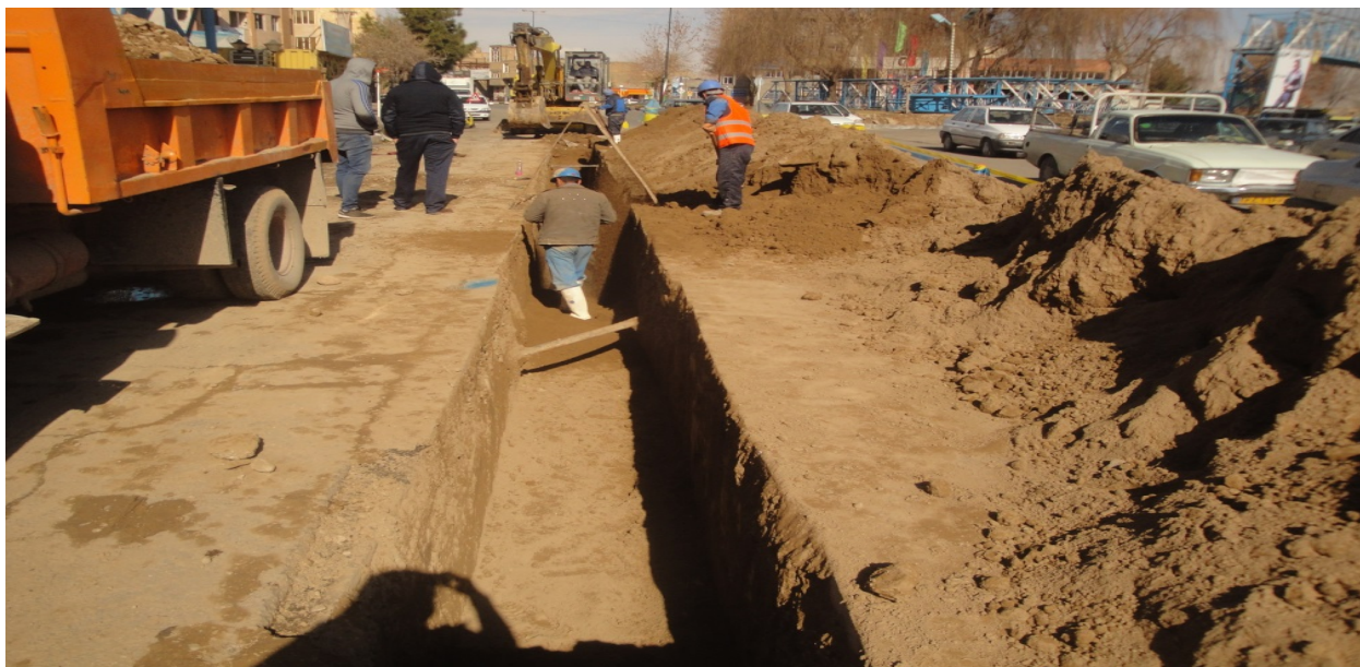
تصویر ۱-۳ پروژه اصلاح و بازسازی شبکه توزیع آب آشامیدنی در سطح شهرستان پیشوا
