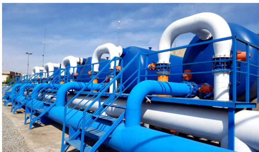
تصویر ۳-۴ تصفیه خانه اضطراری آب در سایت مسکن مهر پردیس
