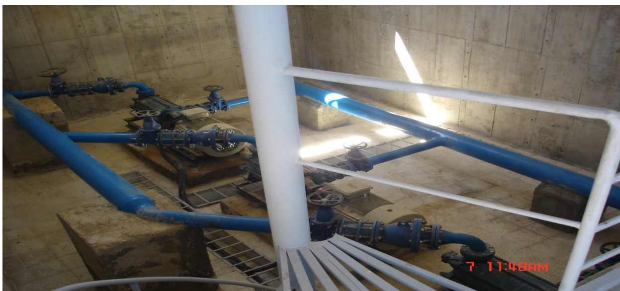
تصویر ۴-۳ ایستگاه پمپاژ آب در سایت مسکن مهر محک دماوند
