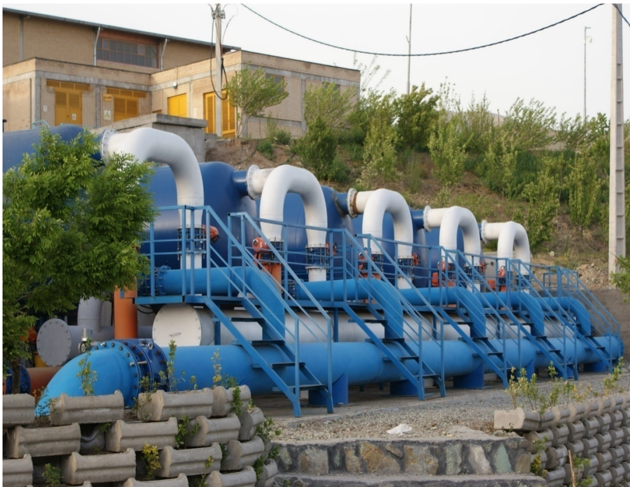
تصویر ۳-۳ تصفیه خانه اضطراری آب در پردیس - تامین کننده بخشی از آب آشامیدنی شهر رودهن
