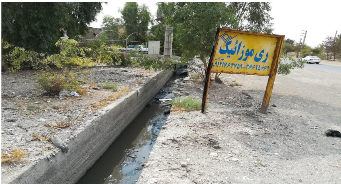
شکل ۳-۷. نمایی از پساب تصفیه نشده شهرک صنعتی عشق‌آباد
